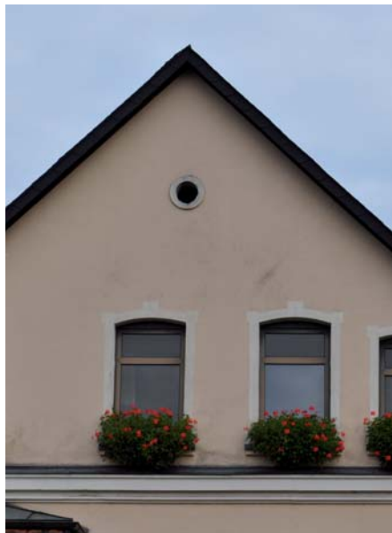
Bild 9: Eulenloch im Giebel Sundern Hauptstraße 82, (Baujahr 1907, Ziegelbauwerk, verputzt)
