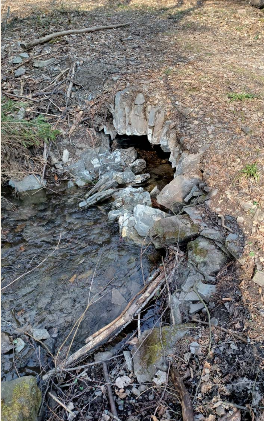
Südseite nach dem Hochwasser
